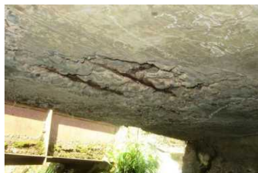
コンクリート床版の剥離・鉄筋露出等 （稲荷2号橋）
