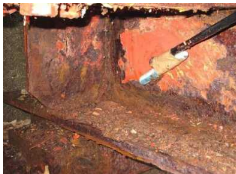
鋼桁の腐食等 （横瀬橋）
