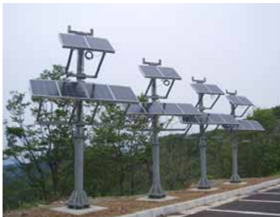
越後駒ヶ岳駐車場トイレのソーラーパネル
